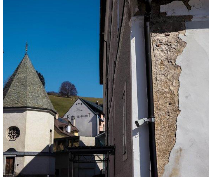
Eine undichte Stelle am Dach des geistlichen Hauses verursachte einen enormen Schaden an Fassade und Mauerwerk.
